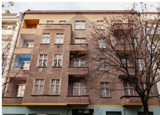
Steht seit Jahren zum Großteil leer: Raumerstraße 31.
